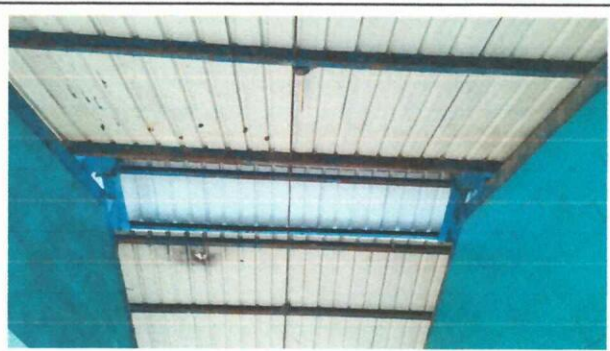
Foto 2: SUSTITUCION DE ESTRUCTURA DE TECHO EN MAL ESTADO
