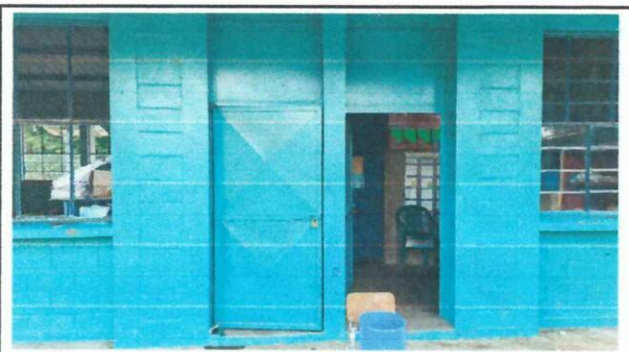
Foto 4: SUSTITUCION DE PUERTAS EN MAL ESTADO
